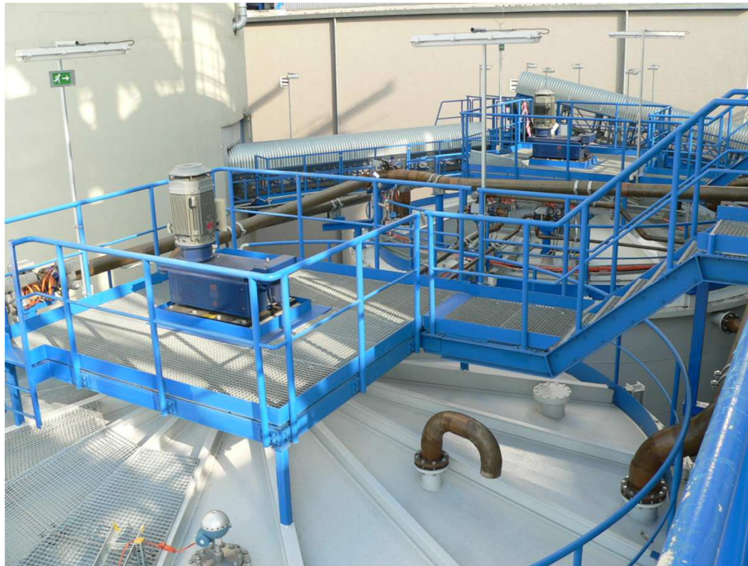
Míchání suspenze a absorbér
