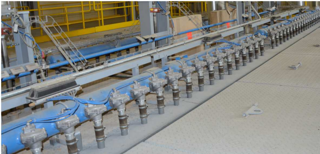
Rozvod vzduchu na profuk
