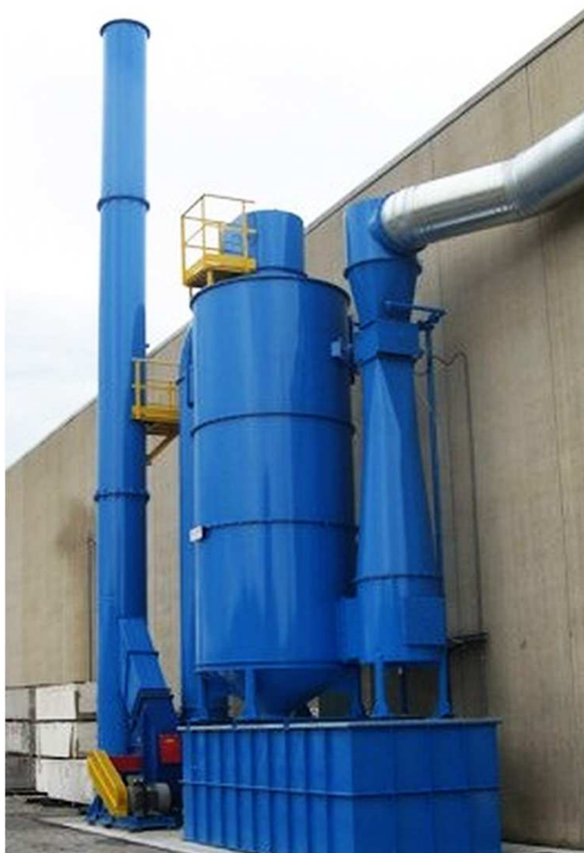
Reálná instalace systému Venturi
