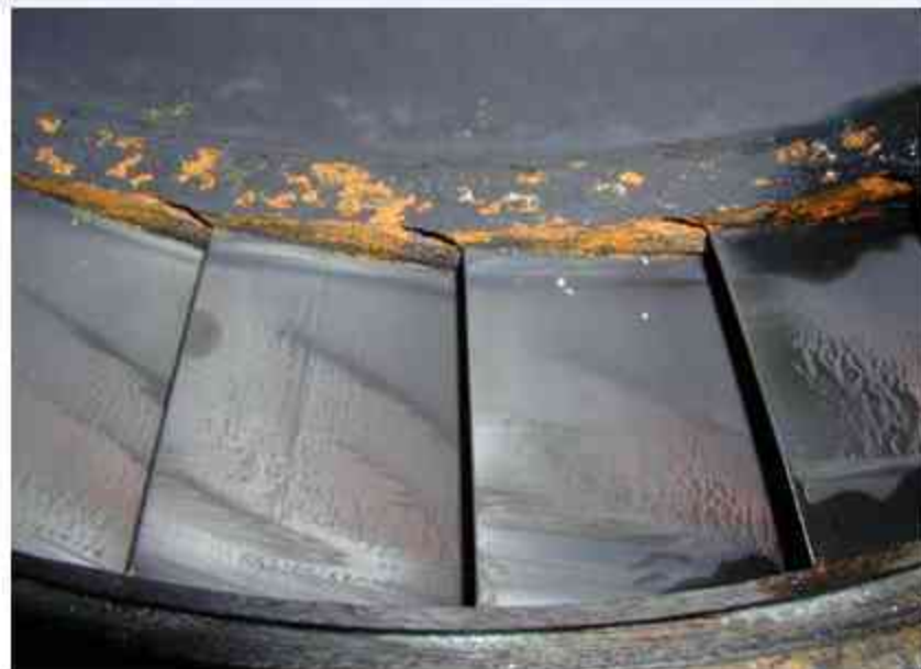
erozní koroze lopatek – vysoká rychlost mokré páry, nízké pH kondenzátu
