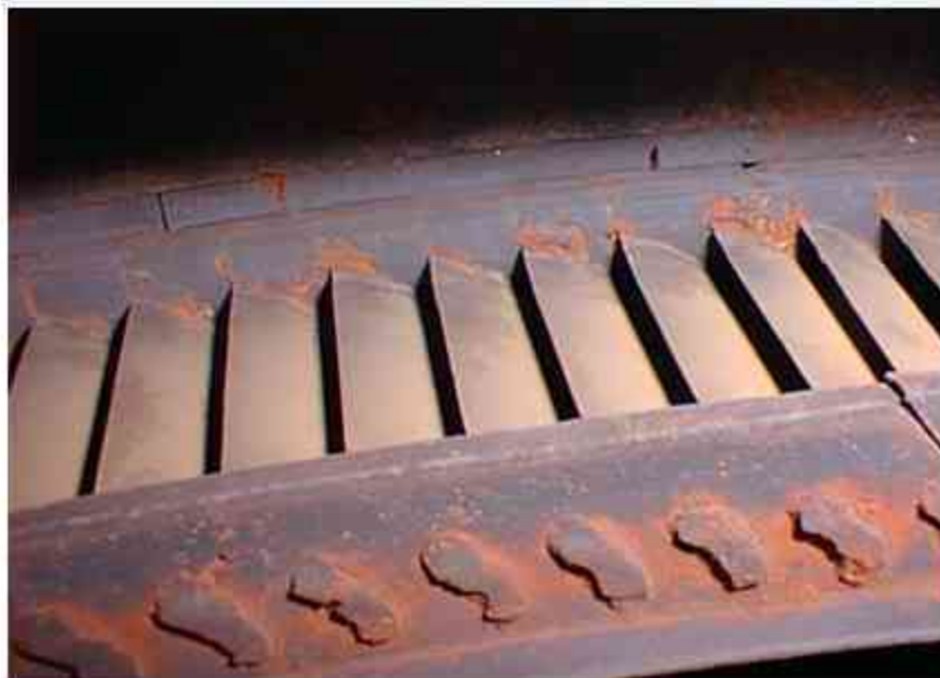
důlková koroze disku turbíny, koroze lopatek – nízké pH kondenzátu na Wilsonově linii
